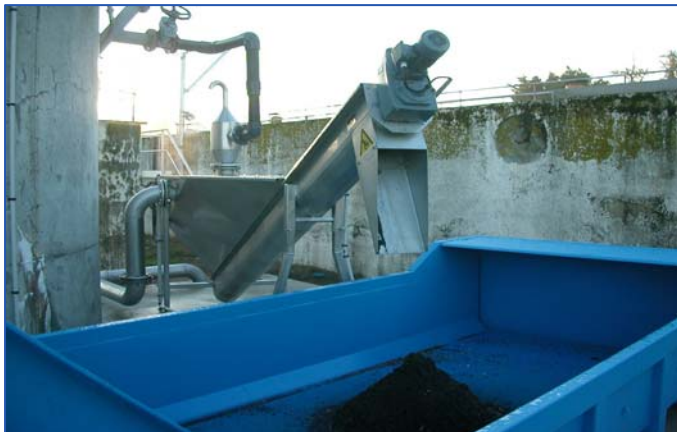
Instalación en exterior
