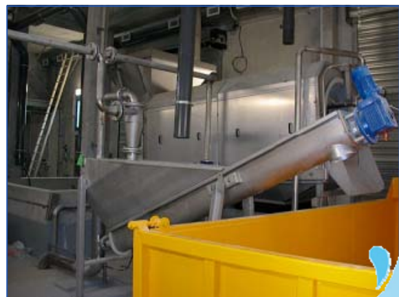
Instalación en interior
